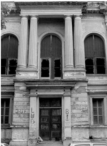
Restauración del Liceo Víctor Mercante 2001-2004 Proyecto original: Arq. Carlos Algelt. Año de construcción: 1886
