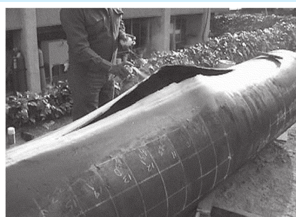
Fig. 1. Falla en ducto.
