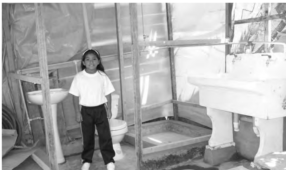
A.H. Villa Victoria, Villa El Salvador, aparatos sanitarios instalados, conformando un espacio de aseo.
