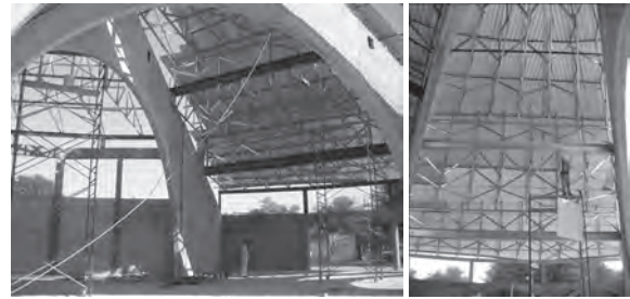
Figura 13. Fotos del proceso constructivo del techo del Templo San Agustín en el municipio de León, Guanajuato, México.
