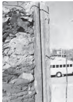
Figura 21. Muro C, área 5 ranuras en el castillo.
